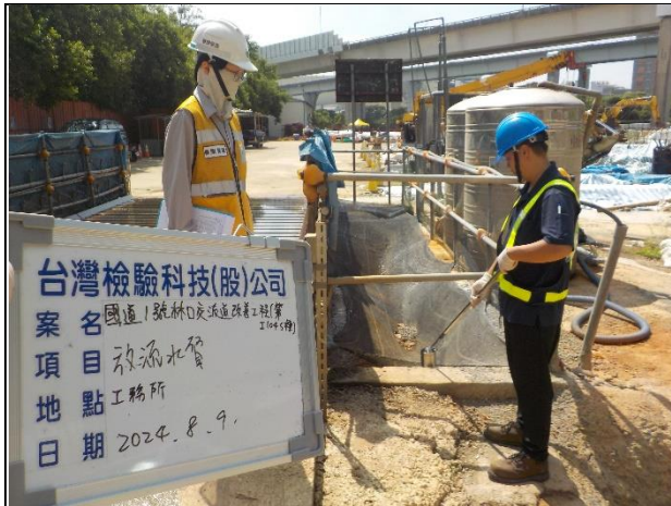
監測項目：放流水質 監測日期：2024.08.09 監測地點：工務所
